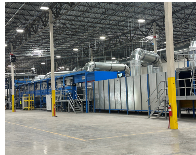
设施内的浇注线。
