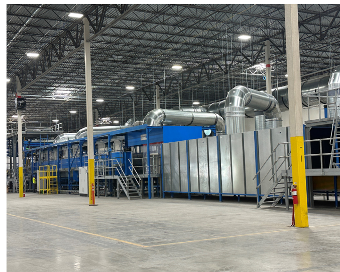
Linia nalewania wewnątrz obiektu.
