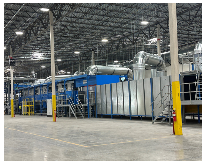
La línea de vertido dentro de la instalación.
